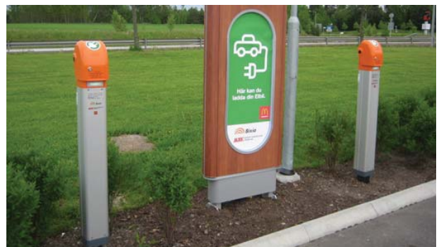
Exempel på laddstolpar för elbilar.
