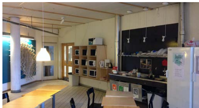
Dörrar till kontor som ej är original byts till nya lika original. Pentryn tas bort och väggar och pelare målas vita.
