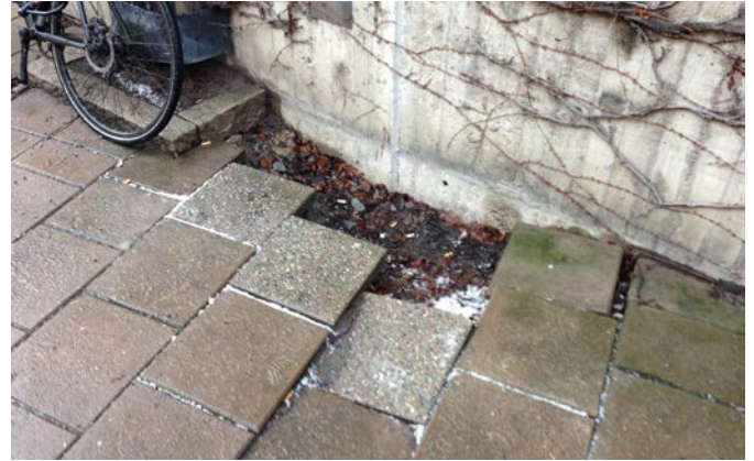
Markbeläggning renoveras och återställs i största möjliga mån, i strategiska lägen inom fastigheten med nytt stenmaterial.
