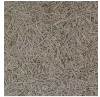
Exponerad träullit i betongtak tvättas och täcks ej.
