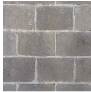
Murad betong i betongsten i vissa inner- och yttreväggar sparas, men håltages vid behov.
