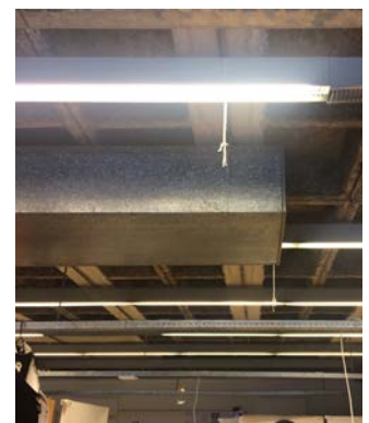
Ritsalarnas ärliga uppvisande av ventilationskanaler och andra installationer i tak.
